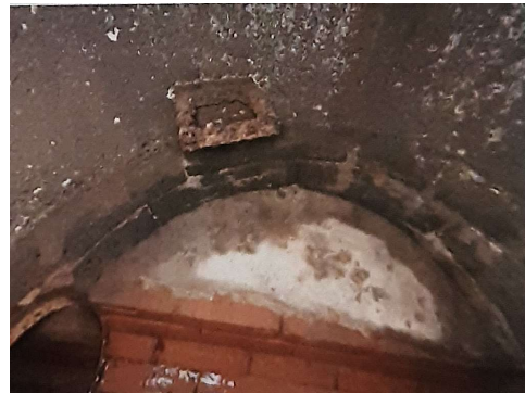
Foto: korrodierte Steigseisen
