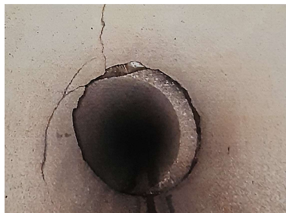
Foto: Rissbildung u. versch. Rohrverbindung
