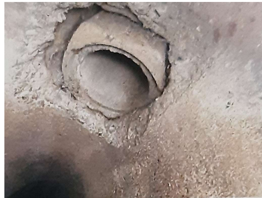
Foto: schadhafter Anschluss
