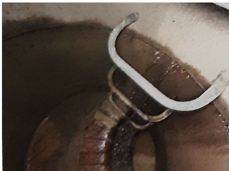
Foto: Infiltration Schachtringfuge
