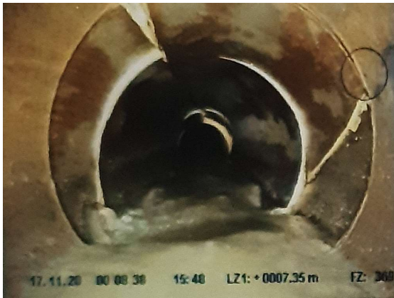
Foto: Rohrbruch mit Infiltration
